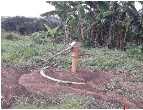
Figura.12.1. Fontenário avariada (Dabuada)
